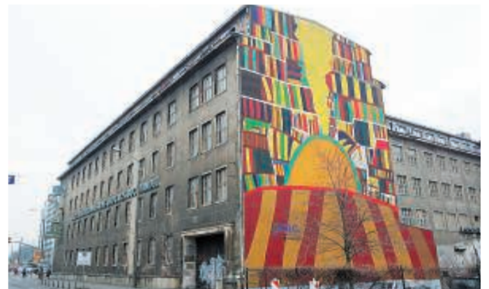
Der frühere Sitz des Leipziger Kommissions- und Großbuchhandels (LKG) an der Prager Straße verfällt immer mehr. Beinahe wäre das denkmalgeschützte Objekt für 1,7 Millionen Euro verkauft worden.
